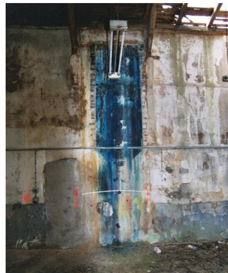
cyanidhaltige Wand (Berliner Blau) in einem Gaswerk
