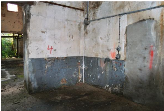
schwermetallhaltiger Farbschutzanstrich (grau)
